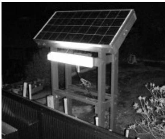
写真9-1 蛍光灯モードで稼働中のソーラ門灯
