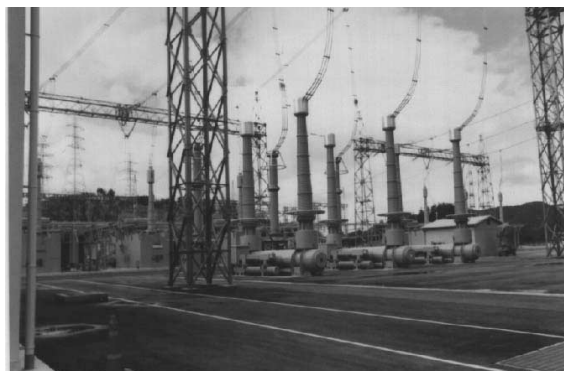
写真1 超高圧変電所
