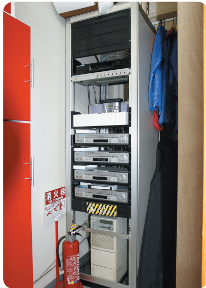
別室にもうひとつあるラックは番組保存用 中央付近にあるVTRレコーダは記録用で、全番組を録音し最低3か月は保管される。下にある機器はUPS(無停電電源装置)で、停電時でも一定時間はスタジオ機器に電源を供給し、放送を継続させることができる。
