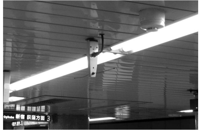
写真1 天井に設置する機器の例
