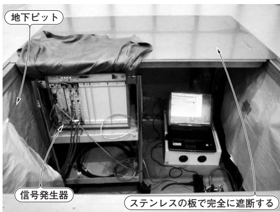
(b) 電波暗室の地下ビット
